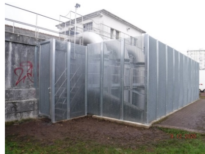
Fermeture garde de corps fosse
