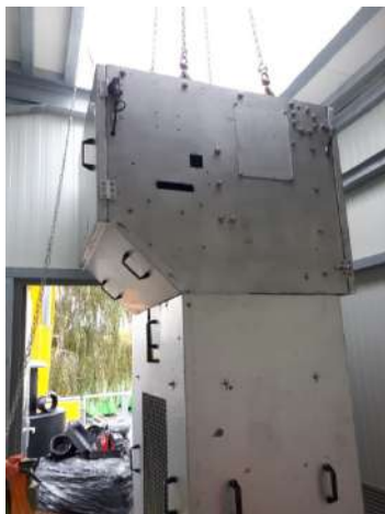
Nouveaux dégrilleurs au poste Sud
