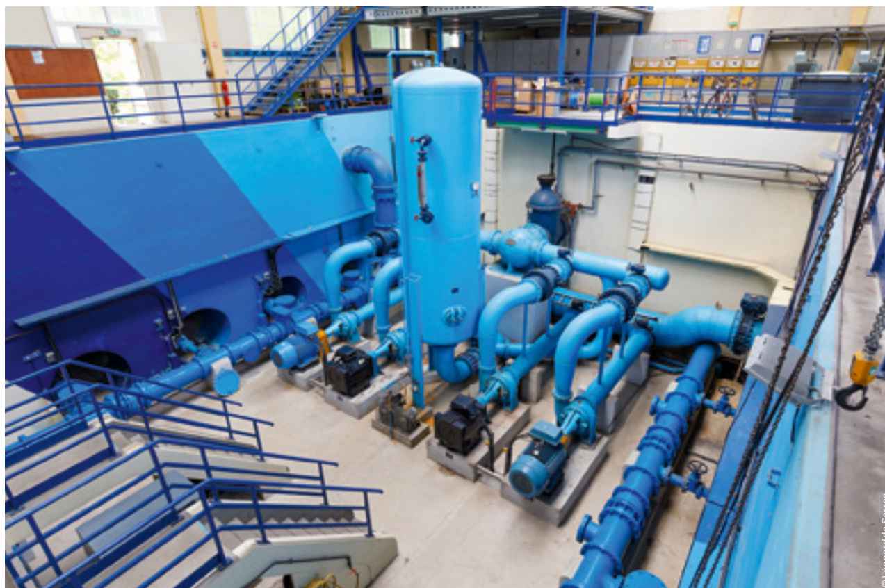
La station de pompage de l'île Aucard (Tours).
