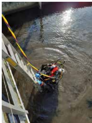
Intervention de plongeurs scaphandriers pour installer les raquettes au fond des bassins
